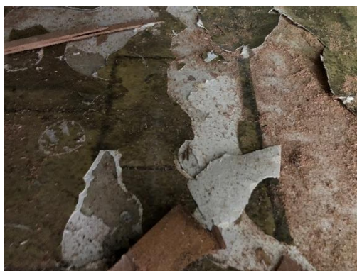
Foto 4: Asbesthoudend vloermateriaal ter plaatse van het kruipluik (1)
