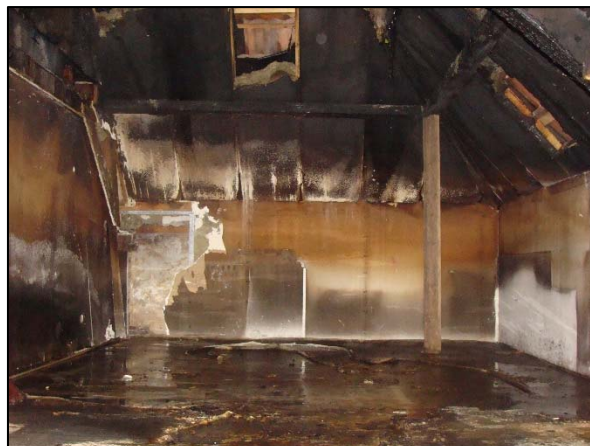
Foto 4. Zolder boven bakkerij met brandschade
