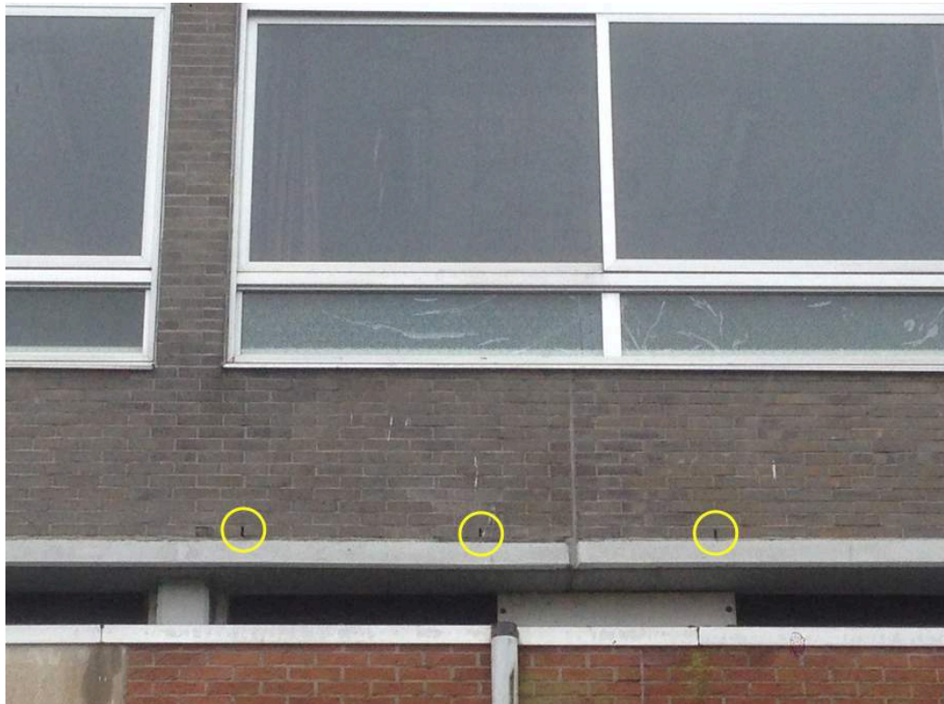
Figuur 2 In de gevels van het schoolgebouw zijn open stootvoegen aangetroffen. Middels deze openingen kunnen vleermuizen in de spouwruimte of andere achterliggende ruimtes kruipen.
