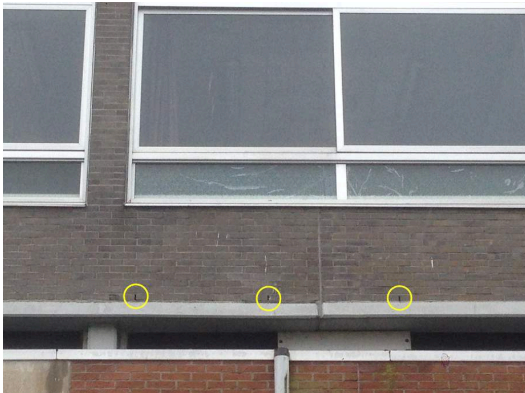
Figuur 2 In alle gevels van het gebouw zijn open stootvoegen geconstateerd. De meeste stootvoegen zijn op een, voor vleermuizen, matig geschikte locatie gesitueerd. Indien vleermuizen gebruik kunnen maken van de spouw (zie tekst) dan dienen ze tenminste enkele tientallen centimeters omhoog te kruipen en vice versa. Ondanks de matige geschiktheid kan aan- dan wel afwezigheid niet op voorhand worden uitgesloten.
